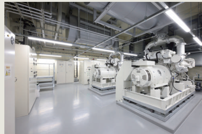
災害対策として72時間稼働可能な自家発電室
