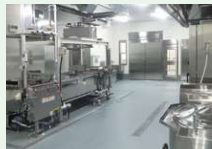
焼物・揚物・蒸物室
