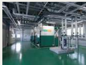
チップボイラー棟内部
