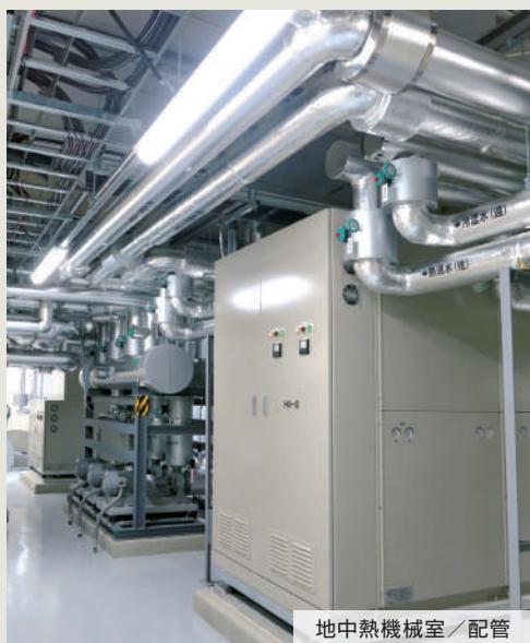
地中熱機械室／配管
