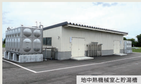
地中熱機械室と貯湯槽
