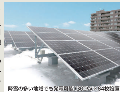
降雪の多い地域でも発電可能(300W×84枚設置)
