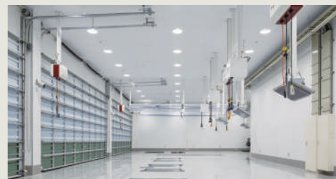
赤外線ヒーターを完備した整備作業場
