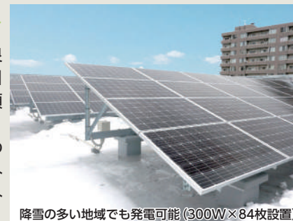
降雪の多い地域でも発電可能(300W×84枚設置)
